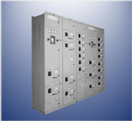
전동기 제어반 (MCC)
