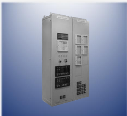
모선 보호 계전기반 (154kV, 345kV, 765kV)
